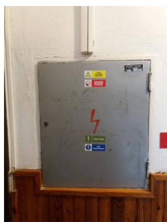
Rozvodnice pred výmenou
